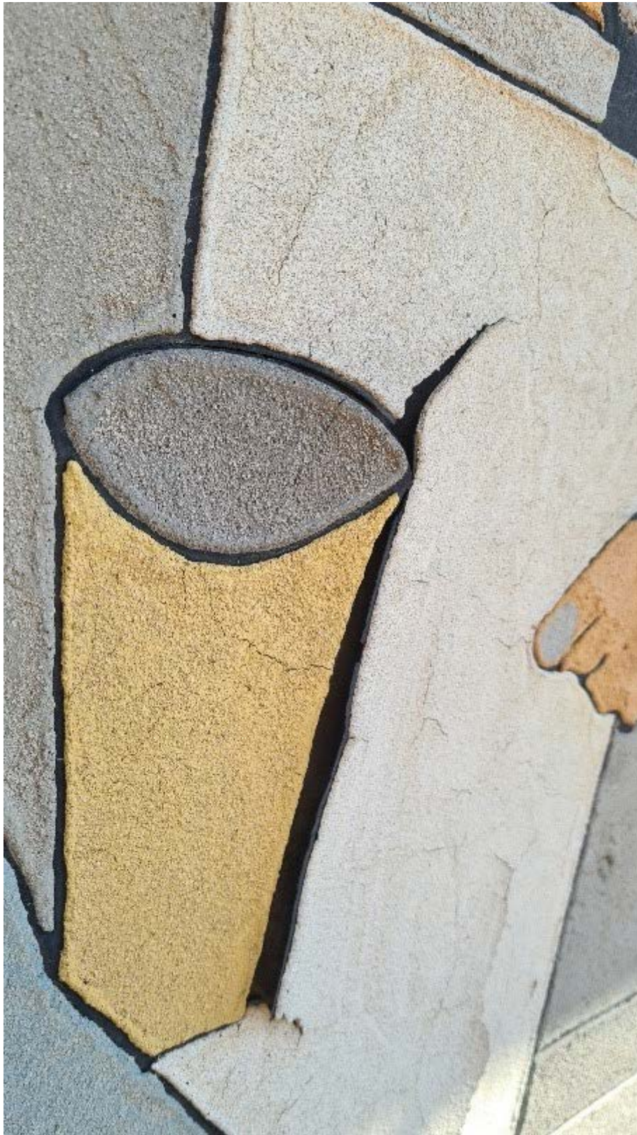
Abb. 21 Detail - aufstehende Putze
