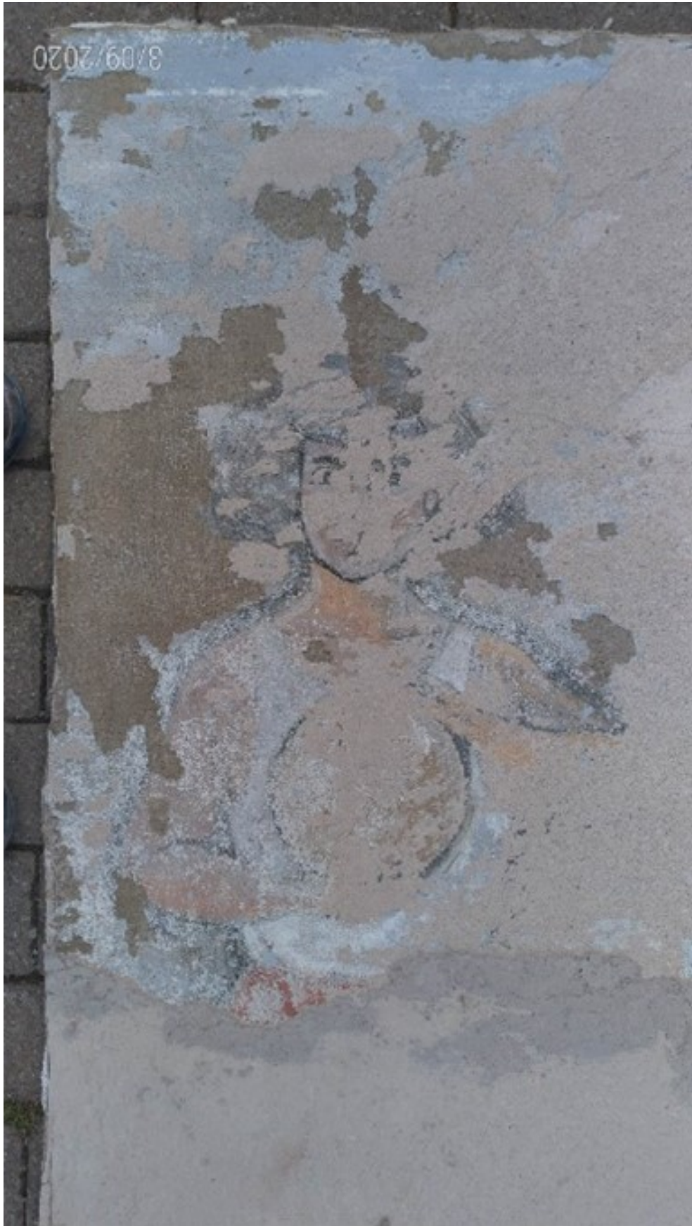
Abb. 21 Detail - aufstehende Putze
